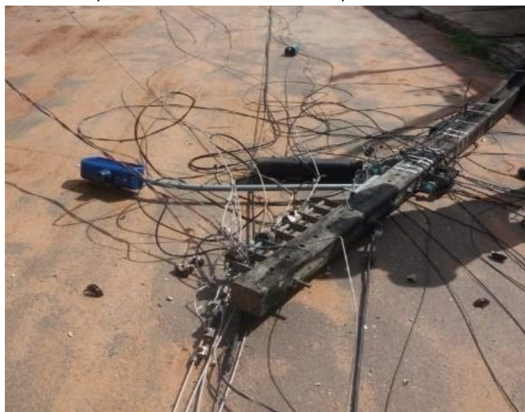
Figura 2 – Postes derrubados em acidentes causam risco de choque elétrico aos moradores da capital do Tocantins
